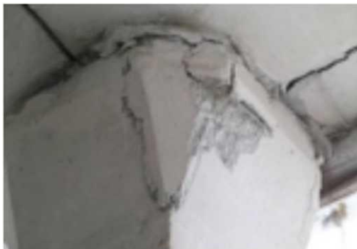
Рис. 4. Сколы бетона капители колонны подсилосного этажа лещадками - поверхностное разрушение защитного слоя бетона капителей колонн без оголения арматуры
